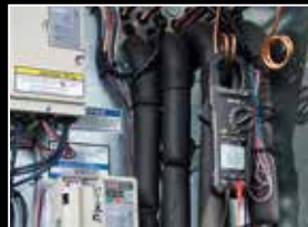
Diagnostique problemas controlados por VFD.
